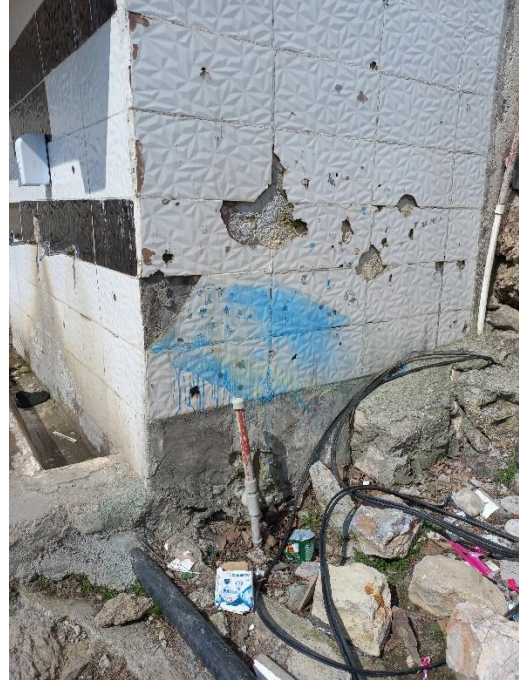
mevcut su deposu çıkış tesisatı
