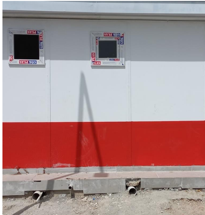
Fotoğraf: Gençlik merkezi atık su tesisatı çıkışları
