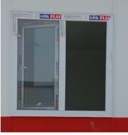
Fotoğraf: Mevcut konteynera ait pvc pencere
