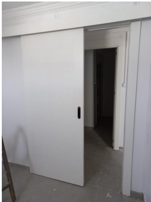
Fotoğraf: Engelli WC mahali sürgülü kapı
