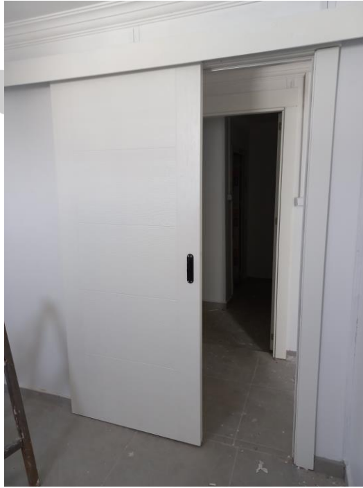
Fotoğraf: Engelli WC mahali sürgülü kapı
