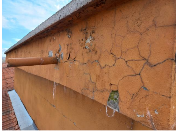
Fotoğraf 3: Bazı sıva tamirâtı ve dış cephe boya uygulaması gerektiren mahaller
