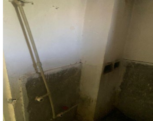
Fotoğraf:Elektrikli Şofben Montaj yeri
