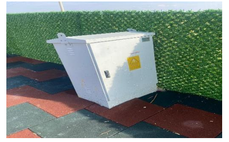
Fotoğraf: Güvenli alana alınacak elektrik panosu
